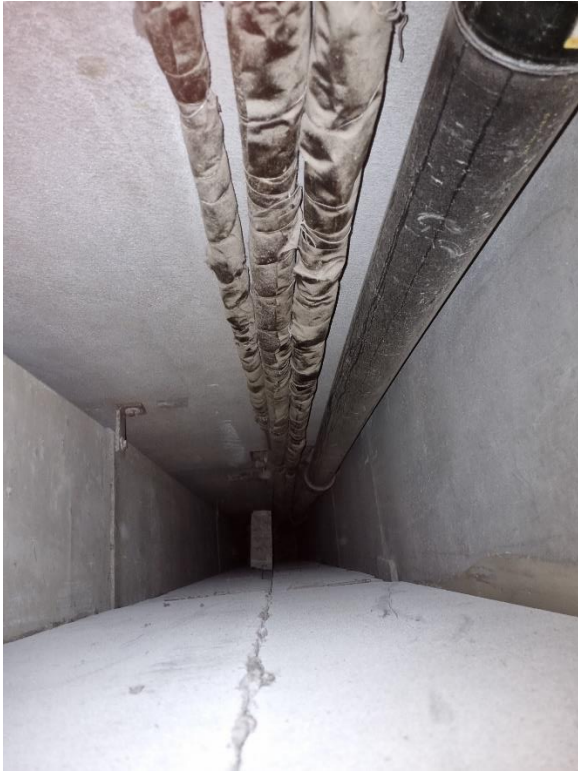
Dålig isolering samt klamring
