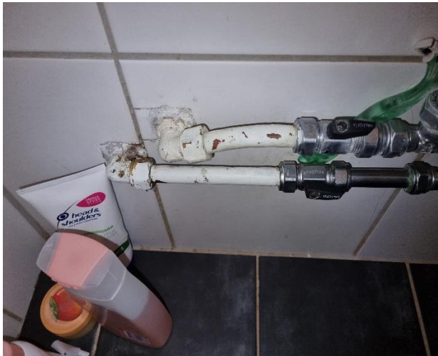
Otät genomföring i dusch.
