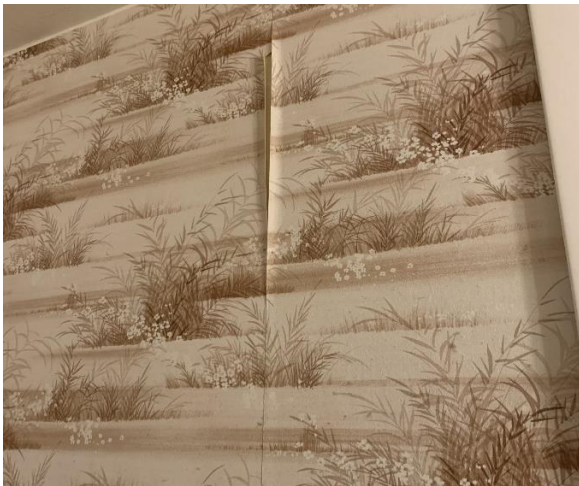
Skadat tätskikt, risk för fuktinträngning.
