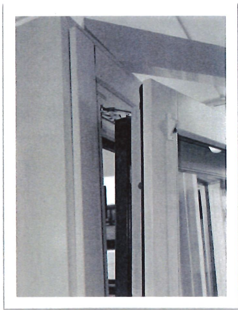
Bågen har släppt från sina gångjärnsfästen i överkant.
